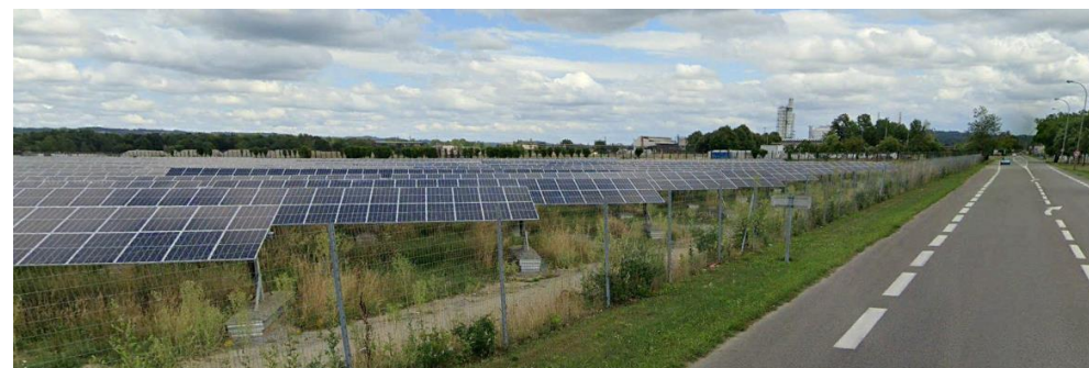
Parc photovoltaïque sur l'ancien site industriel de Pechiney, le long de la D33 à Mourenx
